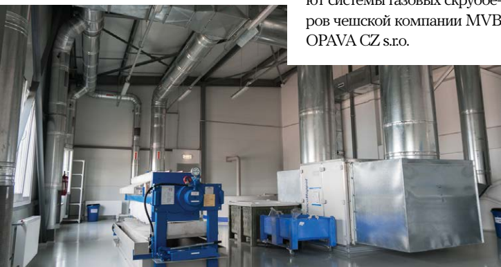
Участок по очистке промышленных сточных вод
